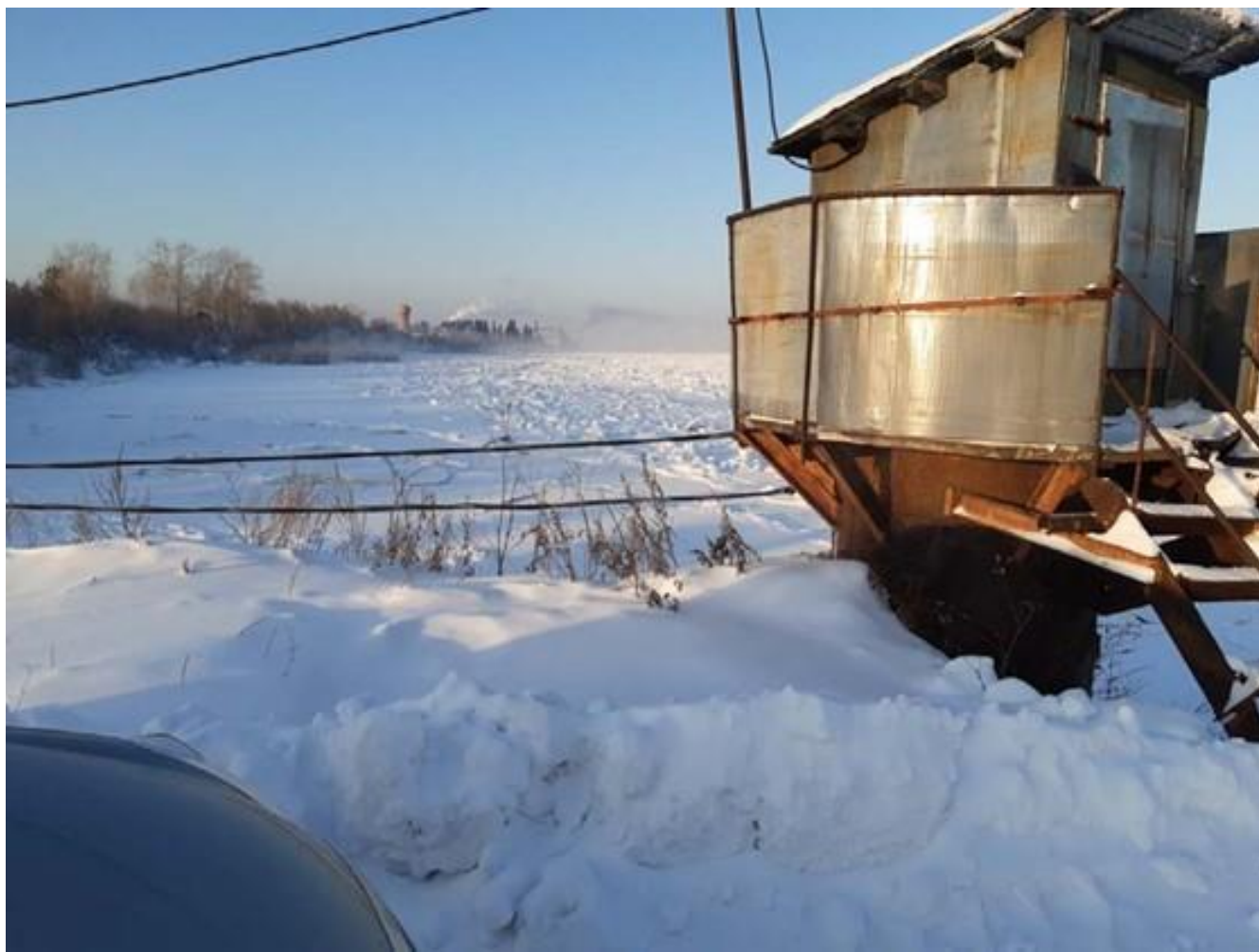
Рисунок 1.12 – Насосная станция 1го подъёма водозаборного сооружения МУП «ЖКХ г. Лесосибирска», внешний вид
