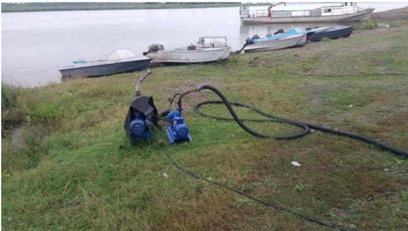
Рисунок 1.18 – Водозаборные сооружения МУП «ПП ЖКХ № 5 п. Стрелка» «Енисей», насосная станция
